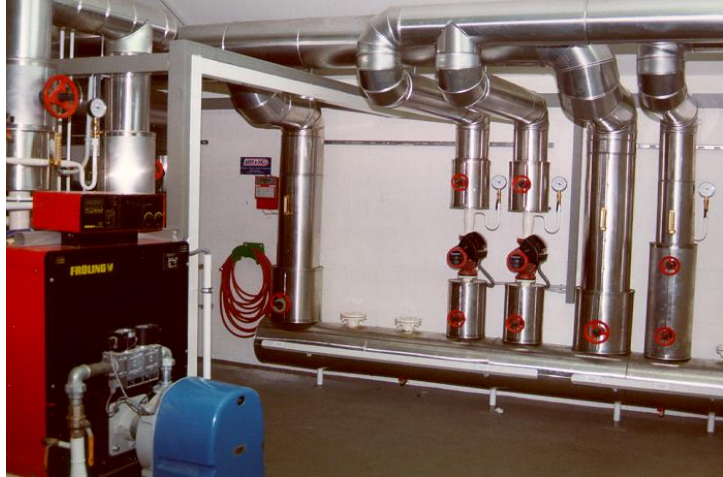
Heizzentrale der Nahwärmeversorgung
